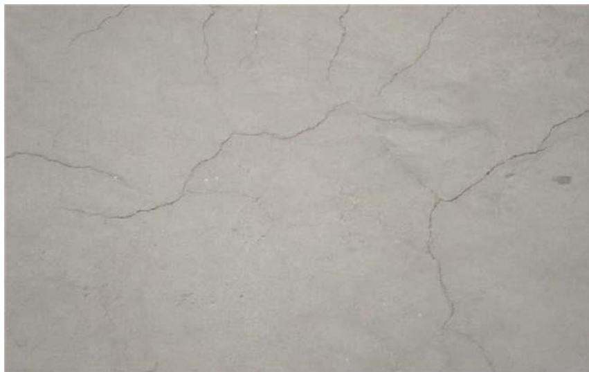
图 2.1.1-1 现浇混凝土板面开裂
