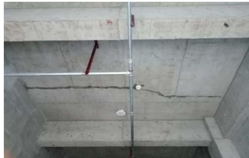
图 2.1.1-2 现浇混凝土板底开裂
