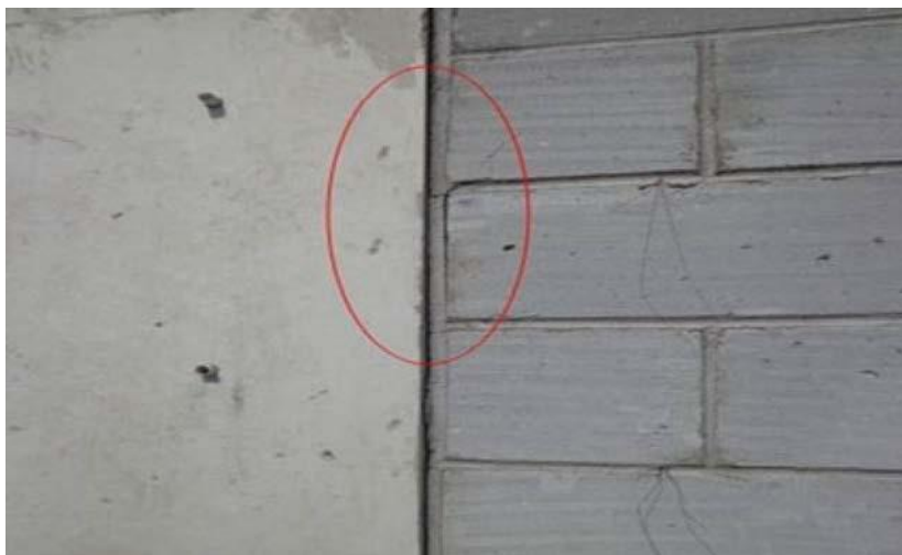
4.3.3 图 4.3.1-1 墙体灰缝处开裂
