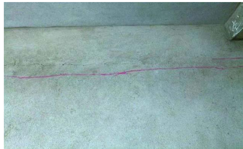
图 4.3.1-1 梁下口抹灰层开裂
